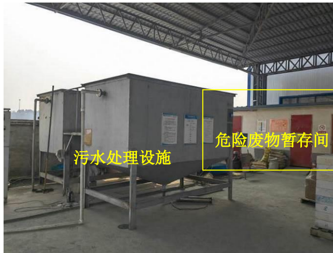
污水处理设施+危险废物暂存间
