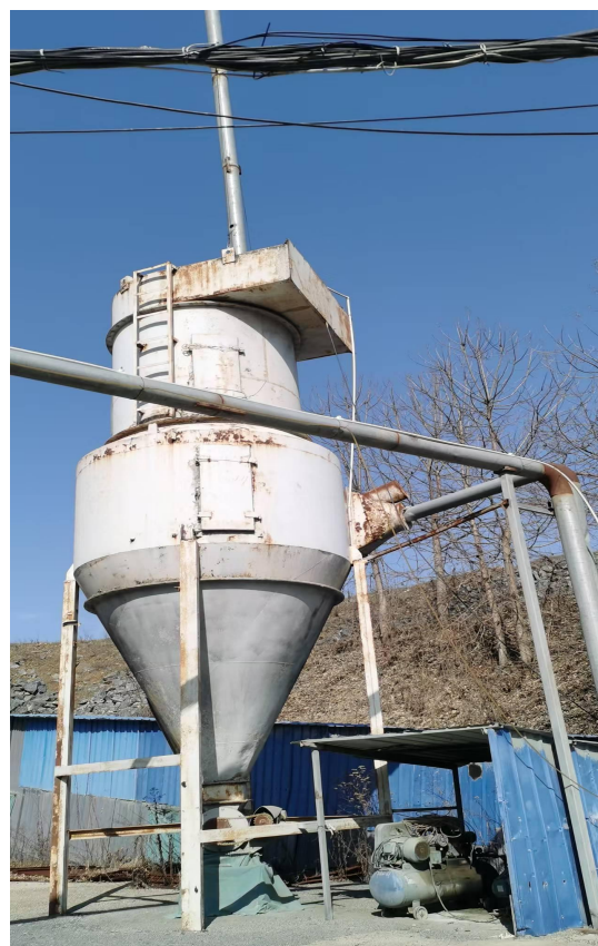
现有工程筛分除尘器
